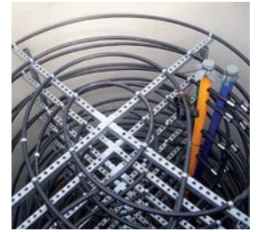
Entzugswärmetauscher im Eisspeicher
